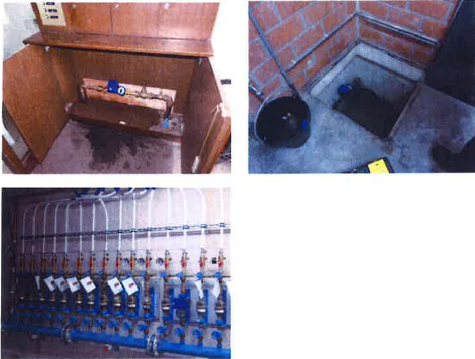
Fig. 1. Watermeter in een inkomhal, in een aparte put, in de kelder van een appartementsgebouw.
